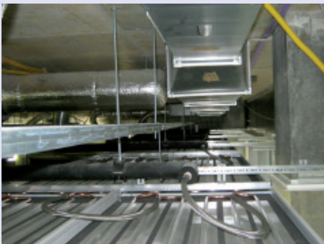
Pannelli di soffitto freddo con veletta acustica continua
