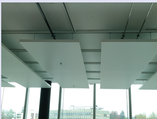
Plafond rafraîchissant dans un bâtiment de bureaux
