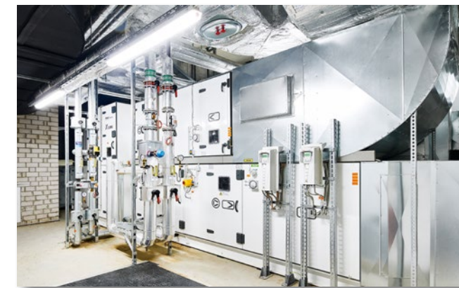
Das RLT-Zentralgerät und eine intelligente Regelung sorgen für eine bedarfsgerechte Luftzufuhr.
